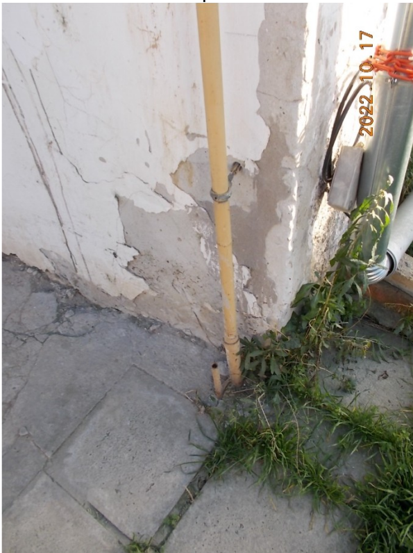
Gázvezeték az épületen
