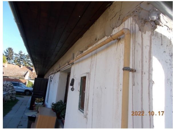
Gázvezeték az épületen
