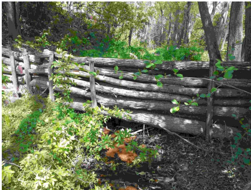
19. ábra Kishozamú, de állandó mellékpatakocskán 2019-2020-ban létesített, „átfolyásos zöldtározó” rönkgátja, Püspökszilágyon 2021-ben.
