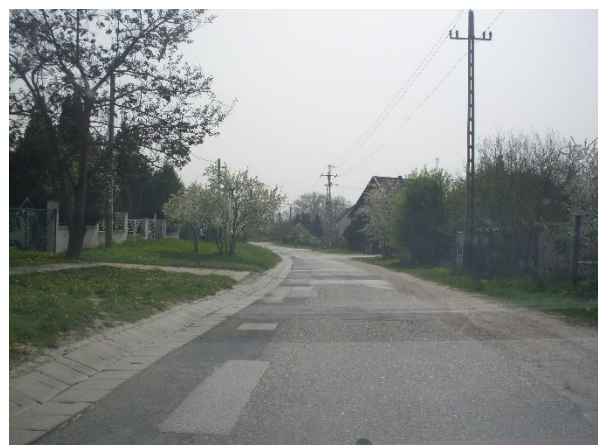
Foltozásokkal tarkított aszfalt burkolat a Vróci úton
