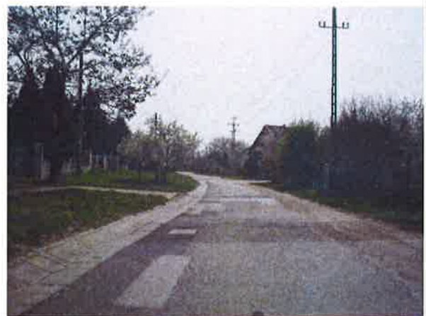
Foltzásokkal tarkított aszfalt burkolat a Vróci úton
