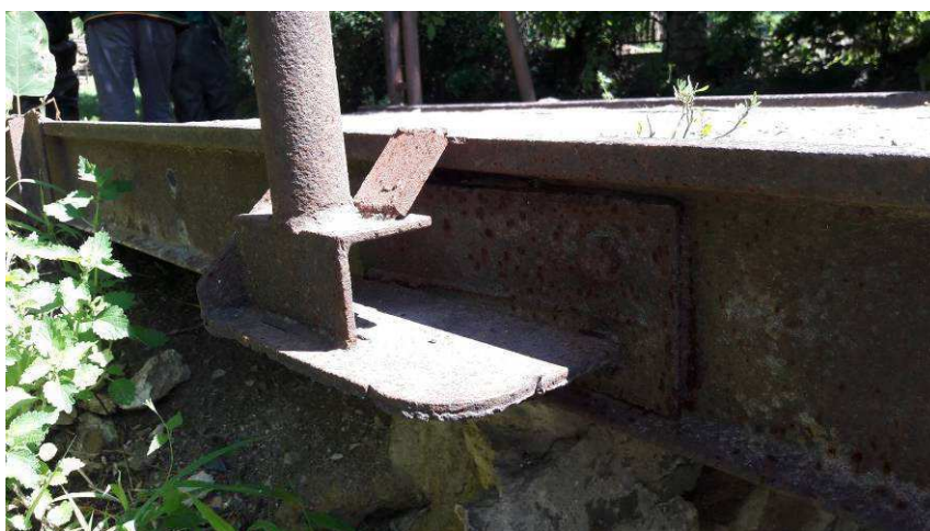
14. ábra: a korlát oszlop főtartóhoz való rögzítése (szakszerűtlen)
