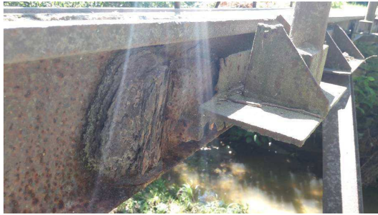
15. ábra: a korlát oszlop főtartóhoz való rögzítése (szakszerűtlen)
